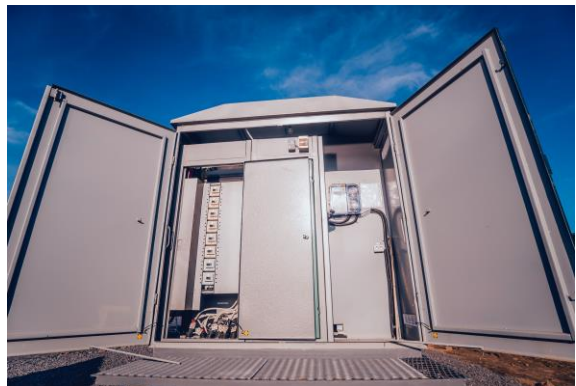
Abbildung 21: Stromspeicher Quelle: Adobe Stock
